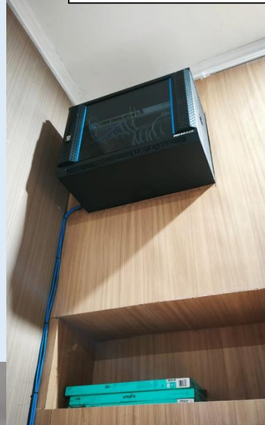
Server jaringan MPP
